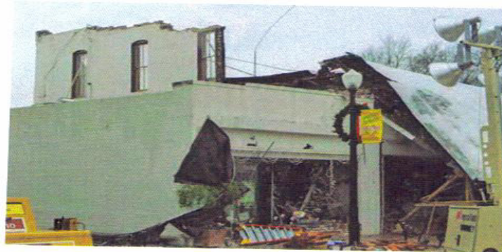
2003年12月22日 San Simeon 地震之后 Paso Robles 市中心的倒塌屋顶。两个人从建筑物向外跑时被掉下的碎片砸死。(USGS photo)
